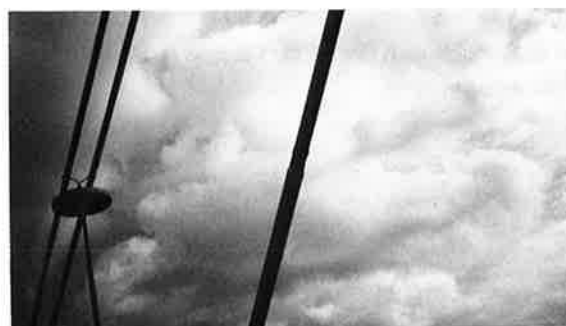
写真-11 ケーブル制振装置
