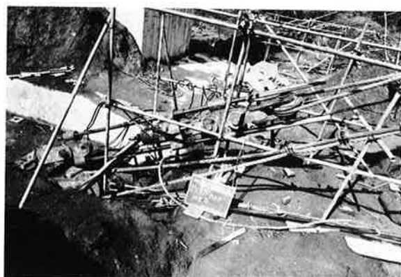
写真-2 ケーブル調整装置
