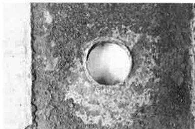
写真-4 リベット孔周りにパンチ傷が残存する例
