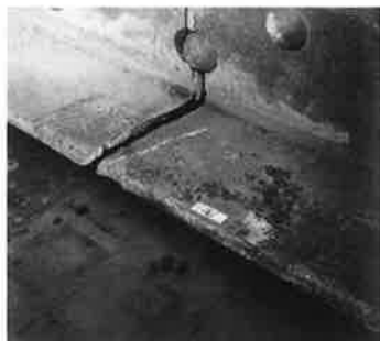
写真-3 試験体Bシリーズ 下フランジの疲労破壊状況の例
