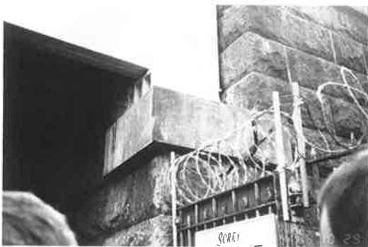
写真-4 アプローチ橋台のクラック
