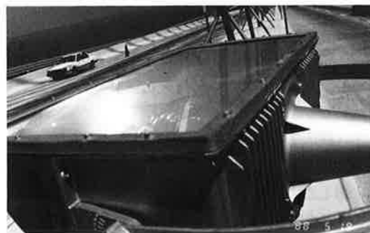
写真-20 ケーブル照明装置
