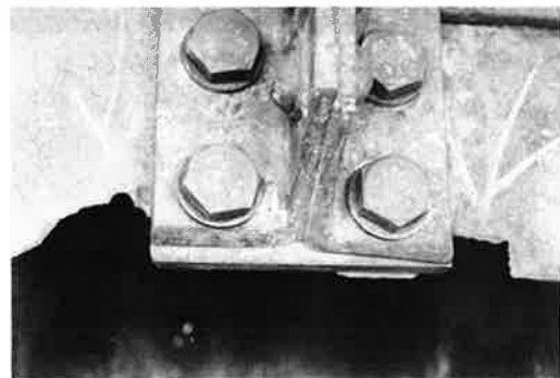
写真-45 床組の腐食状況
