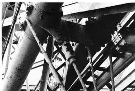
写真-44 ハンガー取付け付近の腐食状況
