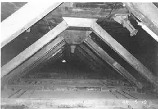
写真-23 桁内部のケーブルアンカーとダンパー
