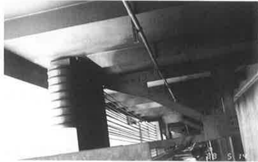
写真-12 ケーブルを使用した落橋防止装置
