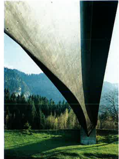
写真-60 人道橋の下面
