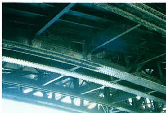
写真-27 ビラケイム橋の下面 (溶接補強が見える)
