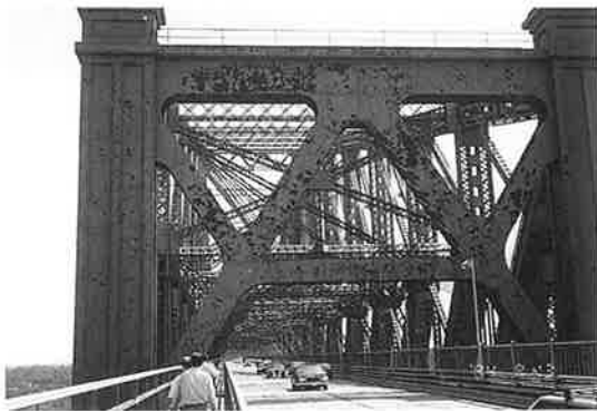
写真-8 ケベック橋の橋門構(錆が目立つ)
