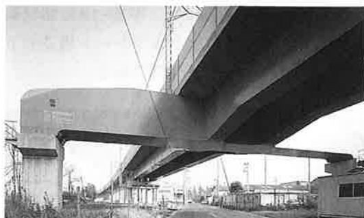
写真-19 鋼受桁を用いた北総線市川有料道路架道橋 (支間長6×平均36.0m 道床式合成桁 1989年)
