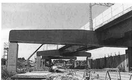
写真-20 鋼受桁(馬桁式)を用いた北総線都計道3.4.20架道橋 (支間長39.45+39.45m 道床式2径間連続部分合成桁 1989年)
