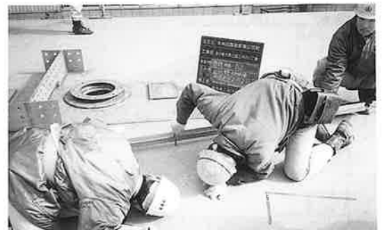
写真-5 初期不整の計測 鋼床版上面の初期不整量を治具を用いて計測している。
