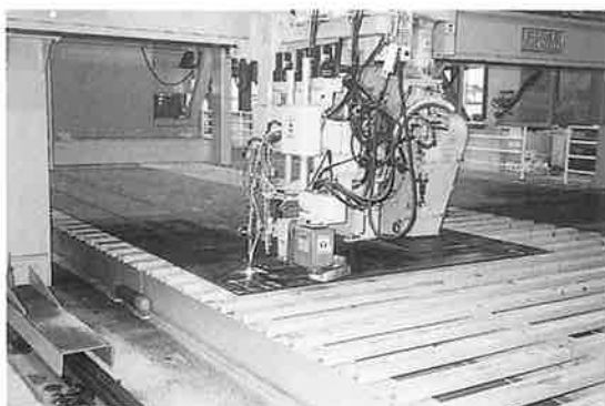
写真-1 NCプライマー剥離, マーキング, 印字装置
