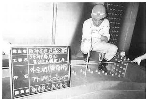
写真-6 座屈状況の調査
