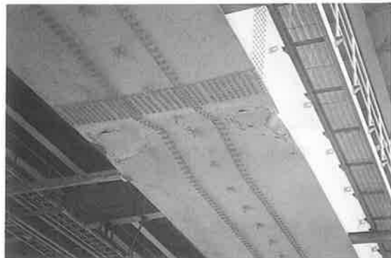
写真-5 座屈部 (外主桁)
