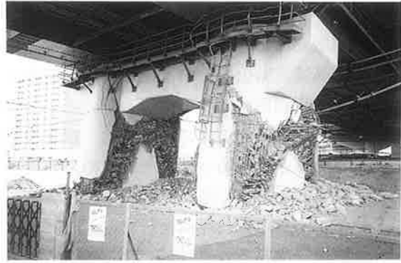
写真-1 P688橋脚崩壊状況
