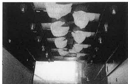
写真-1 タイプ A 裏面損傷状況
