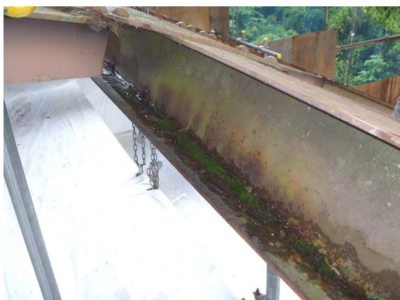
写真-16 泥等の堆積状況
