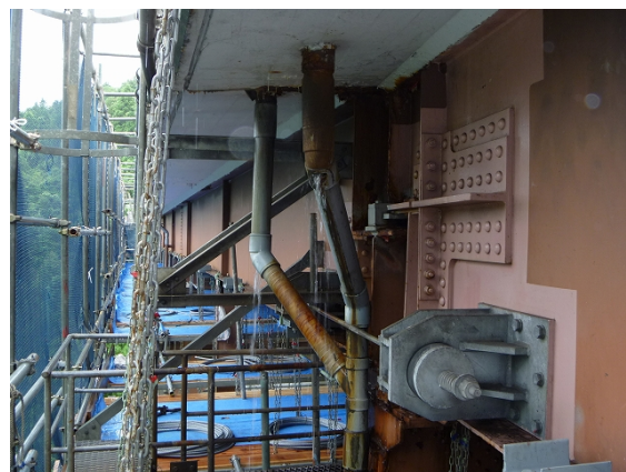
写真-17 排水管損傷状況
