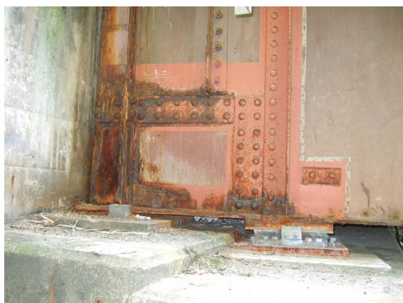
写真-14 桁端部腐食状況
