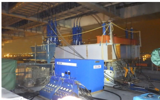
写真-10 吊上げ装置
