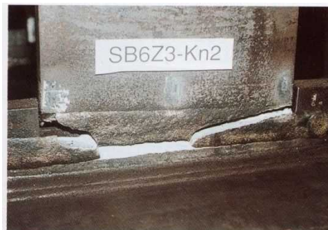
図 2 梁フランジ溶接部の破断 3)
