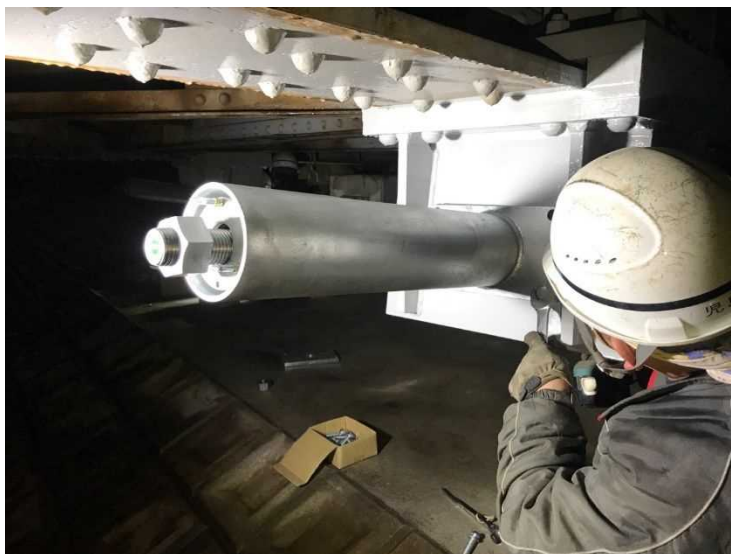
落橋防止装置設置状況
