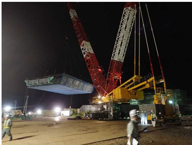
750t 吊ラチスブームオールテレーンクレーンによる一括架設
