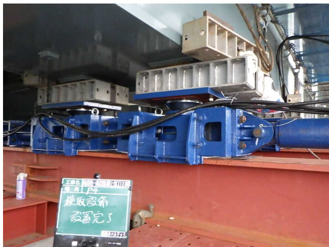
写真-4 逸脱防止用ガイド設備
