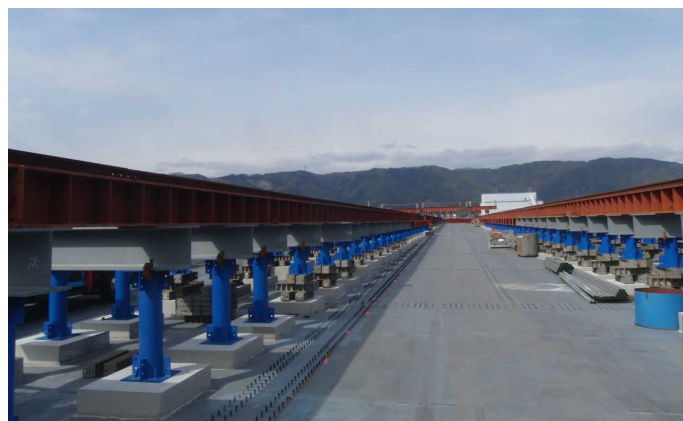
写真-1 軌条設備
