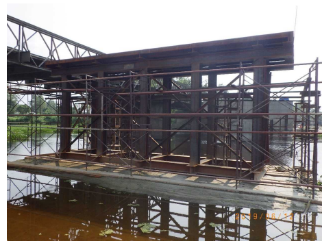
写真-4 ベント設備
