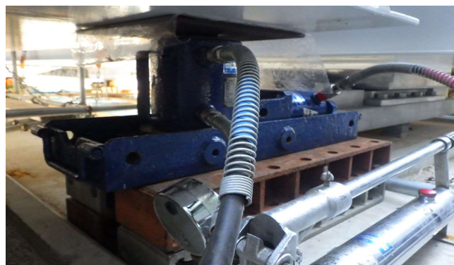
写真-3 IP1 橋脚上の油圧ジャッキ式調整装置
