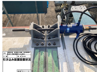
写真-4 引込装置 (桁上)
